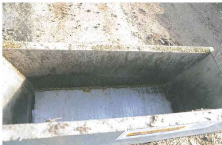
Blick in die Hydroschleuse: gut zu sehen ist der Schieber, der sich öffnet, wenn das Futter in die Hydrolyse eingebracht werden soll.
